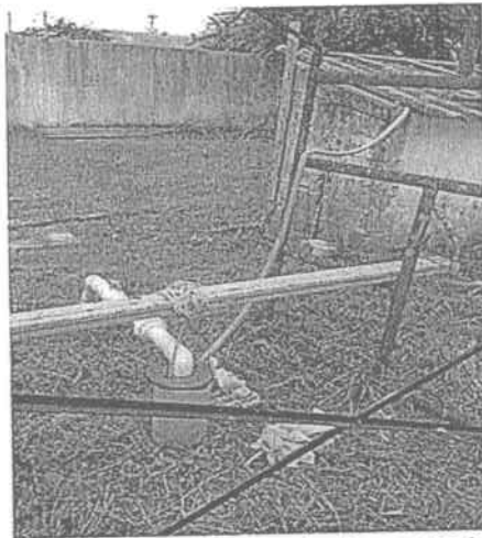
Fotografía No. 1 Pozo Profundo, aun costado caseta de control eléctrico y al fondo Tanque de Almacenamiento de Agua captada.
